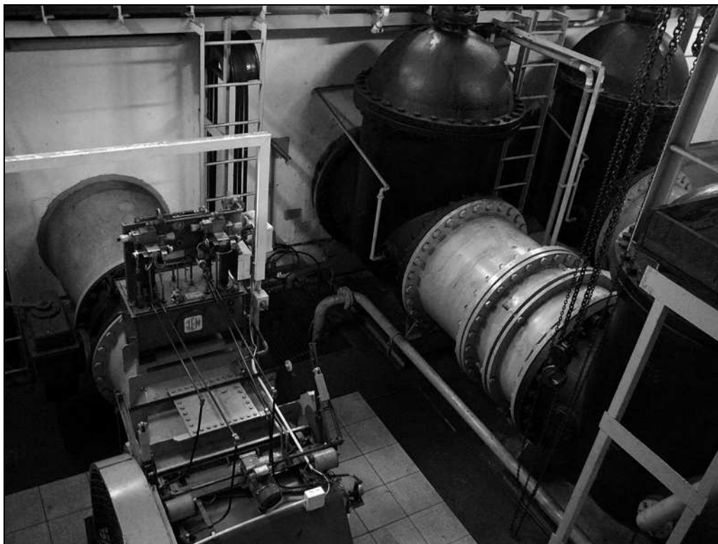
Fot. 1. Turbina w MEW Cieszanowice, autor: J. Lik
