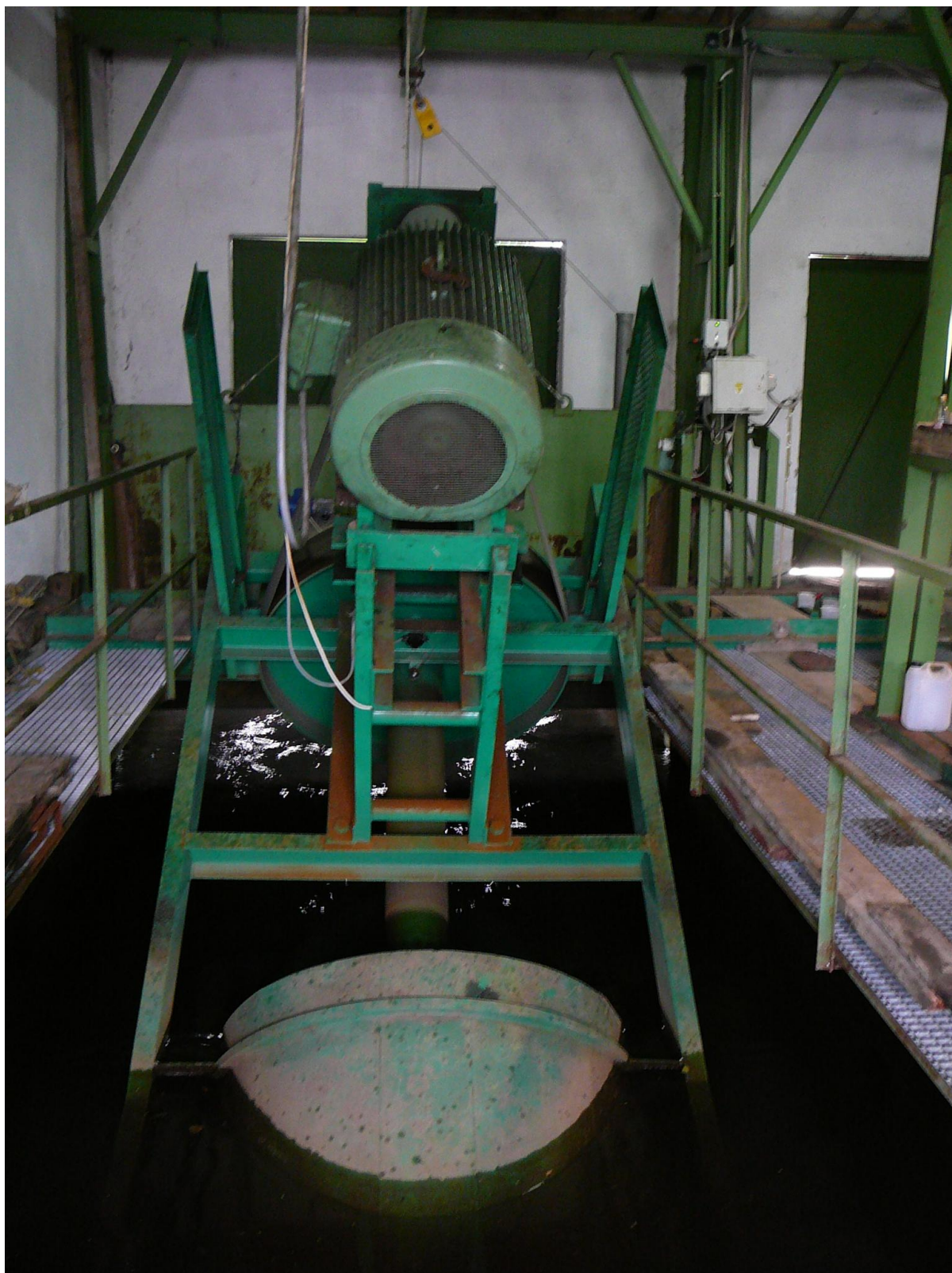
Fot. 5 Turbiny kaplana w budynku siłowni elektrowni wodnej "Podgórze"
