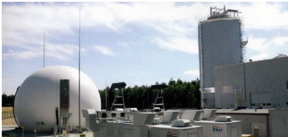
Rysunek 19. Instalacja DRANCO w Zakładzie Zagospodarowania Odpadów w Trzebani
